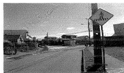
Osorno La Mayor Norte frente al N° 2038 , instalación de señal "PROXIMIDAD Paso CEBRA".
