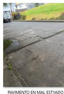
PAVIMENTO EN MAL ESTYADO
